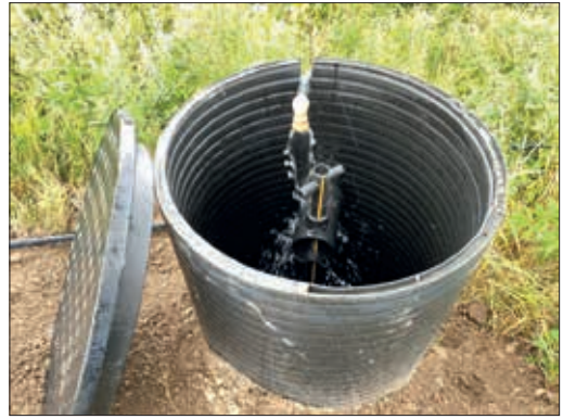
Säätökaivo, johon pumpataan vettä kasvukauden aikana.
